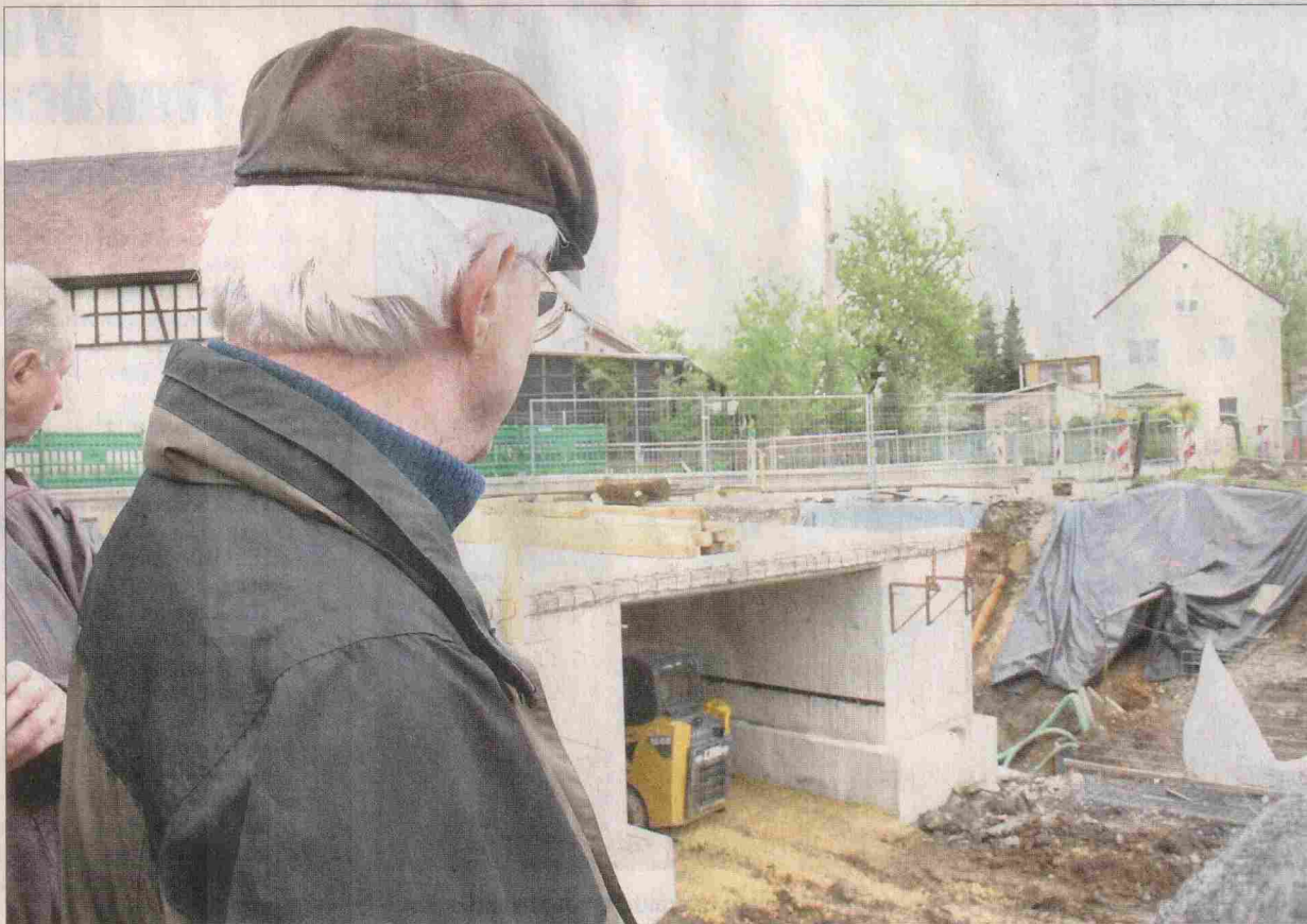
Einwohner blicken auf das neue Bett des Negisbaches in Dorna. Die Brücke steht schon. Das Ufer wird hier mit sogenannten Gabionen gestaltet, mit Steinen gefüllten Drahtkörben. (Foto: OTZ/Katrin Wiesner)
